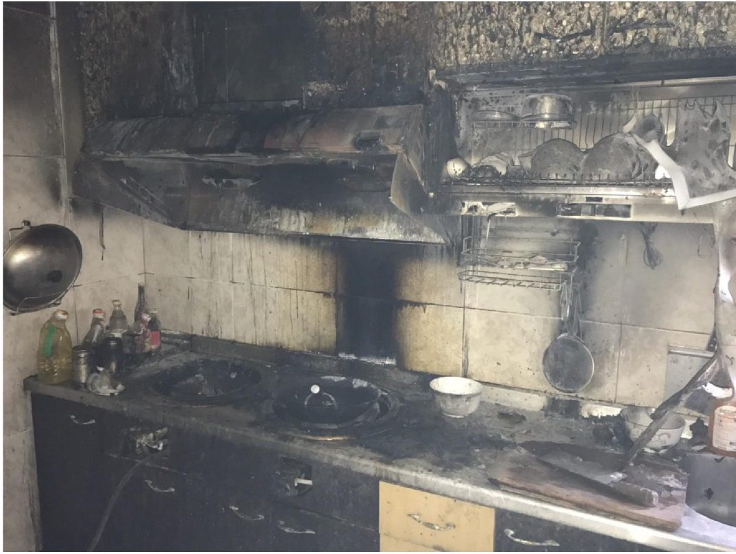
現場燒損情形。
