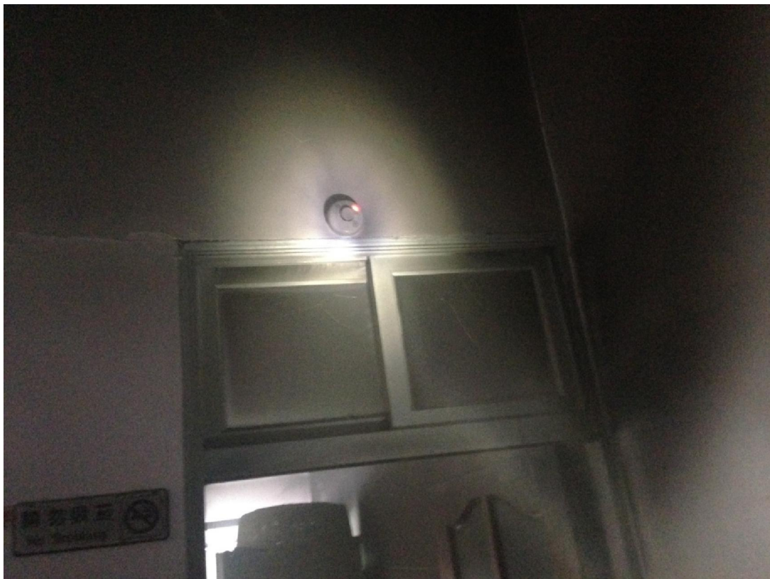
現場住警器動作照片(紅色燈閃爍，並發出逃生警訊)
