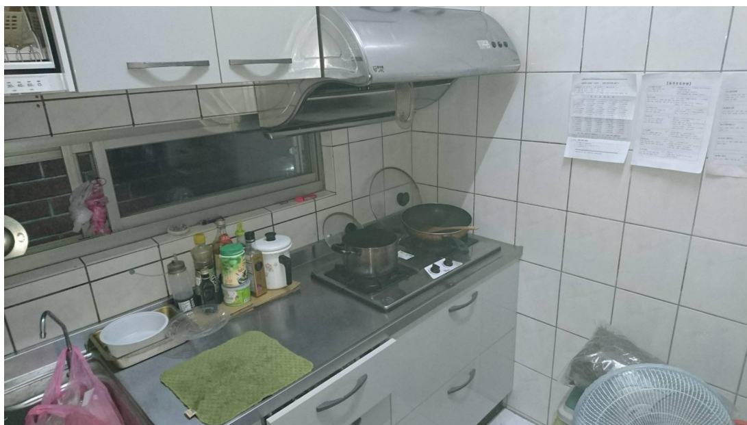
圖片一：現場因炊事不慎致爐具燒焦情形。
