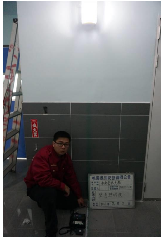
說明:緊急照明設備、照度測試遠景
