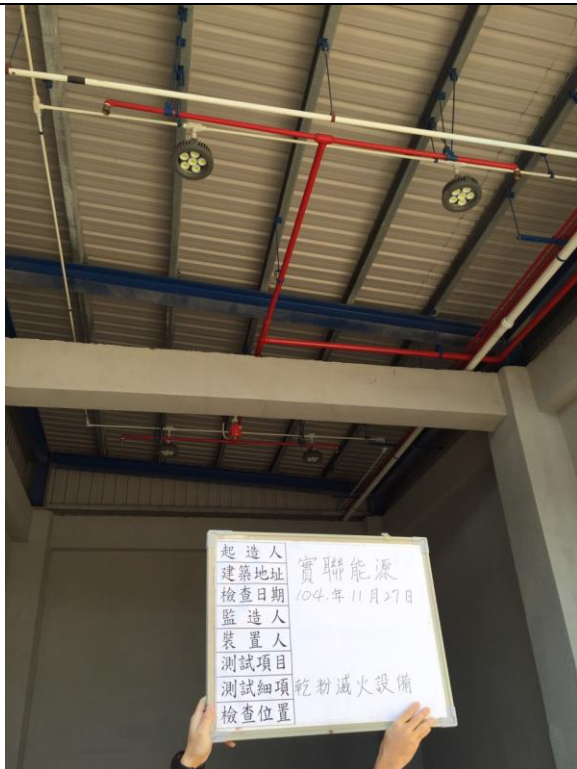
說明：乾粉(二氧化碳)滅火設備配管、噴頭、探測器實景
