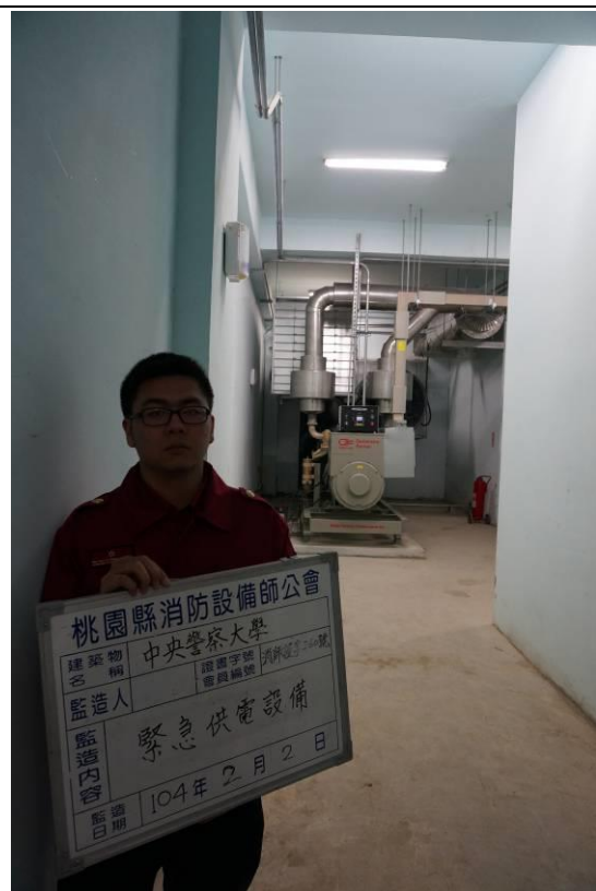
說明：發電機室全景
