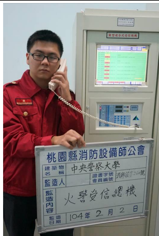
說明：火警自動警報設備總機(副機)外觀
