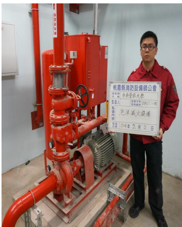
說明：室內消防栓加壓送水裝置
